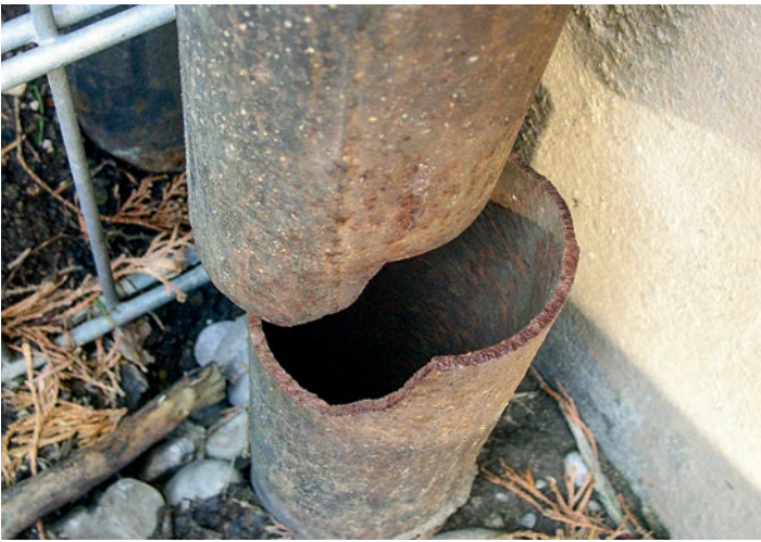
Ursache für das Auftreten von Ratten: offene oder defekte Dachabwasserläufe müssen geschlossen und/oder repariert werden.
