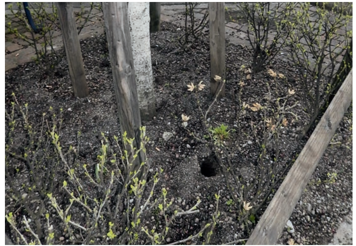
Rattenloch in einer Baumrabatte. Die Ursache: eine defekte Abwasserleitung im Untergrund.
